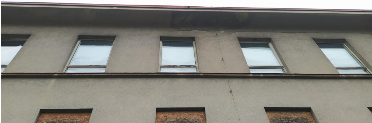
Foto 6 – Poruchy na římsách
